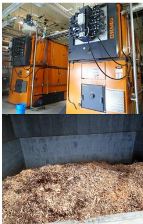
上：芦別スターライトホテルに導入された木質チップボイラー
