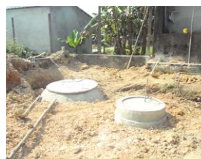
建設後のバイオガスダイジェスター
