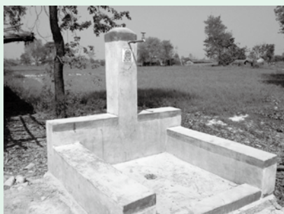
使われなくなったバダハラ村の水道の給水地点。各戸給水ではなく、5~6世帯で一か所の蛇口を設けるのが、ガンジス流域の村落給水では一般的
