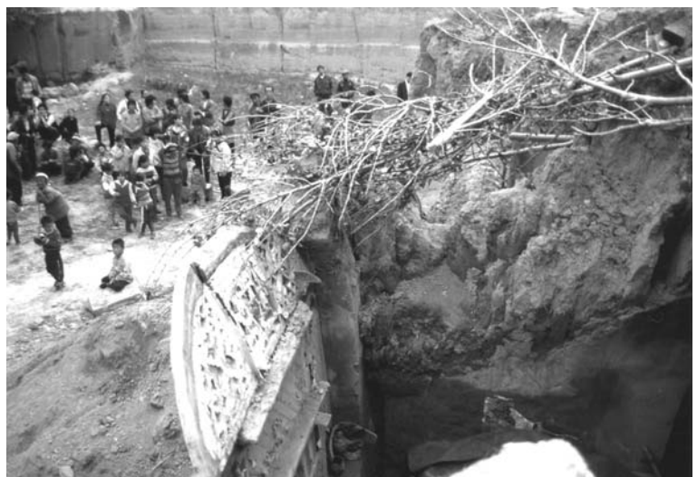
長雨のため、屋根や壁に水がしみ通って倒壊した土造りの窑洞
