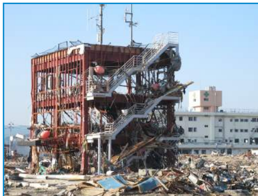
図Ⅲ-1 被災した南三陸町防災対策庁舎
